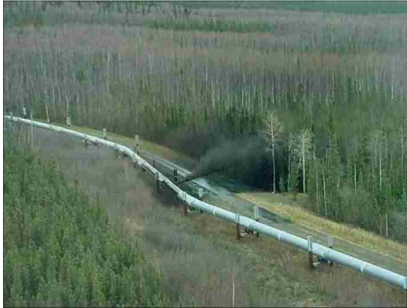
Рисунок – 1.5 Прорив трубопроводу в Альберті, Канада, 2001
