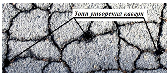
Рис.2.8. Характер утворення мережі тріщин на поверхні дорожнього одягу автомобільної дороги
