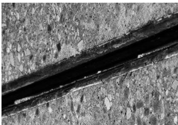
Рис.1.3. Температурний шов бетонного полотна автомобільної дороги, який заповнено асфальтовим наповнювачем (інтернет-ресурс
