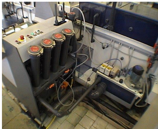
Рис. 6.9 – Вигляд установки відновлення водних розчинів (мідніння) (вид на насосний блок)
