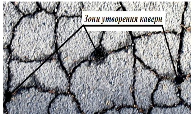
Рис.4. Утворення мережі тріщин та каверн на поверхні дорожнього одягу автомобільної дороги
