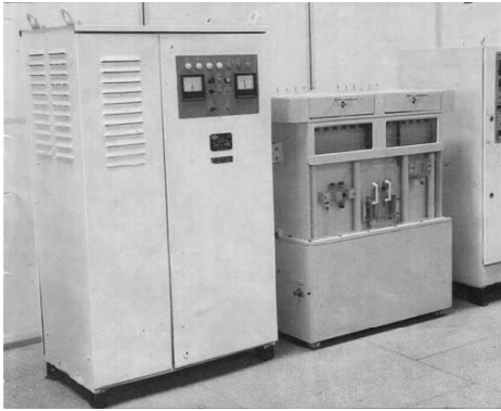
Рис. 21. Установка відновлення кислих водних розчинів
